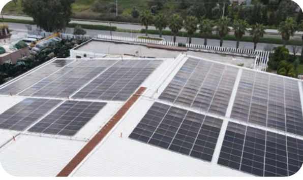
Muğla Gümüşdoğa / 260 kWp
