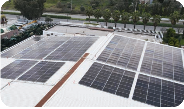
Muğla Gümüşdoğa / 260 kWp
